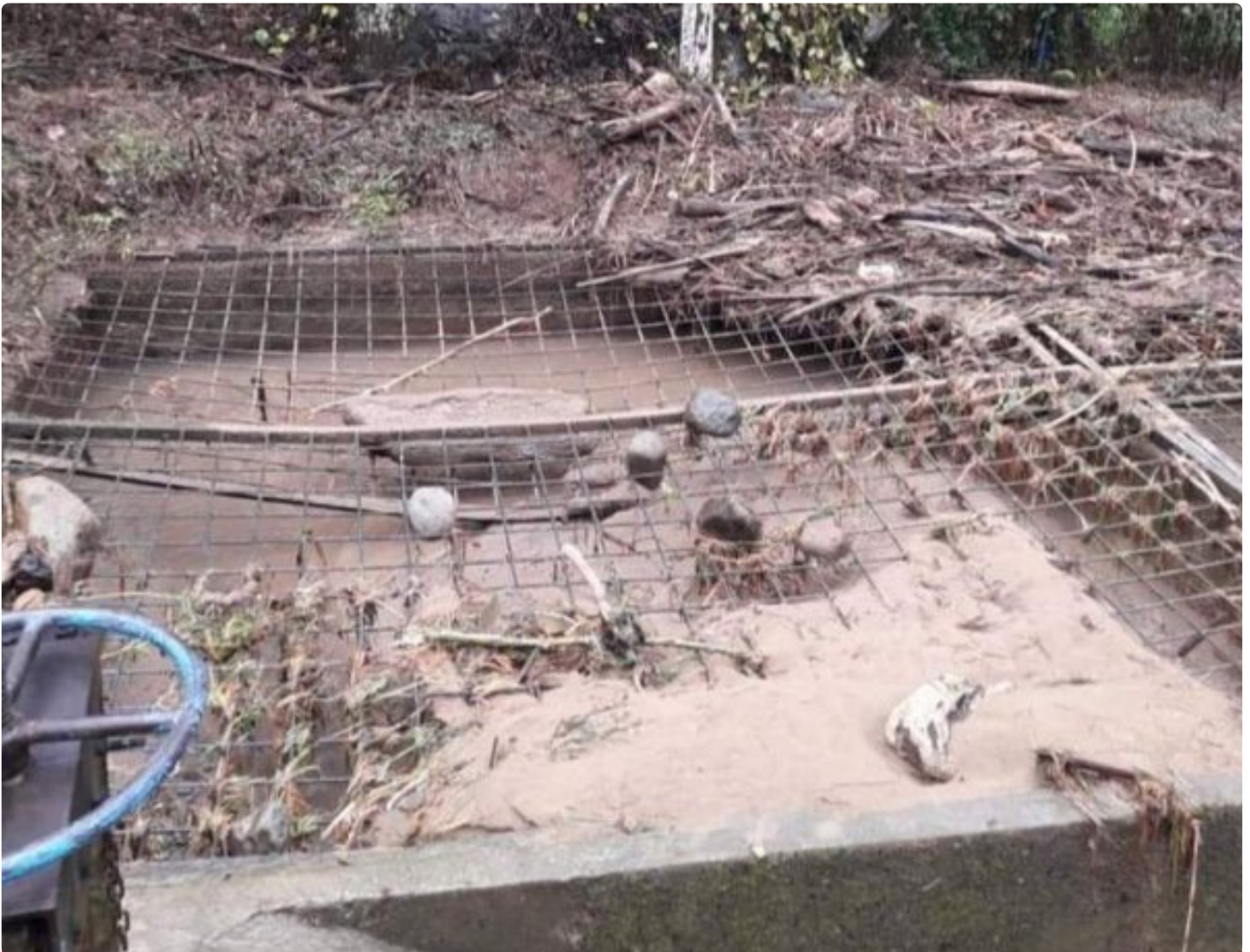
Salah satu Intake Perumda Tirta Sakti jebol akibat intensitas hujan tinggi. Foto: Sony
